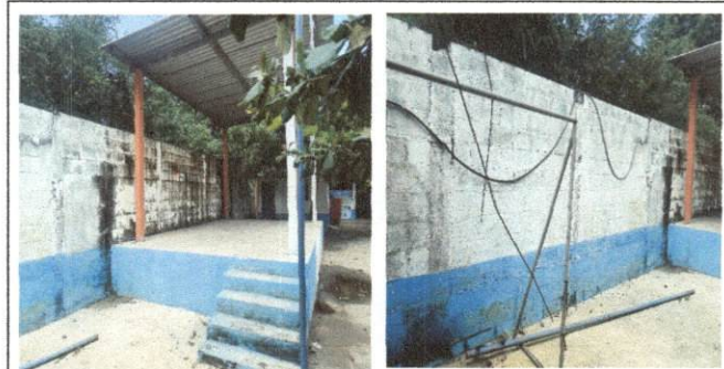
Foto 6: Muro Colindante en mal estado, se reforzara el mismo.
